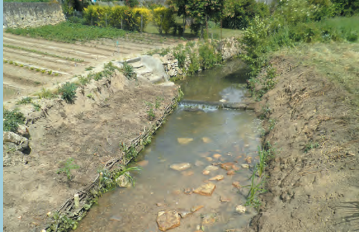
Travaux de confortement de berge à l'aide du tressage de branches Sepmes aux Coteaux - Juin 2011
